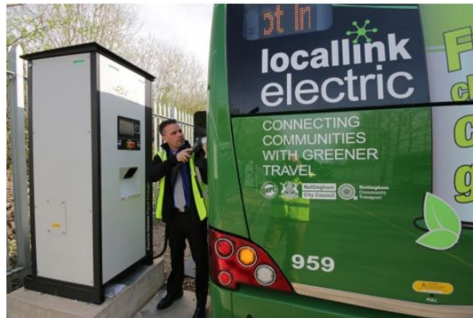
شكل (7) محطات شحن الباصات الكهربائية
